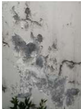
Gráfico 2. Afectación por humedad en pared de patio Fuente: Elaboración propia
